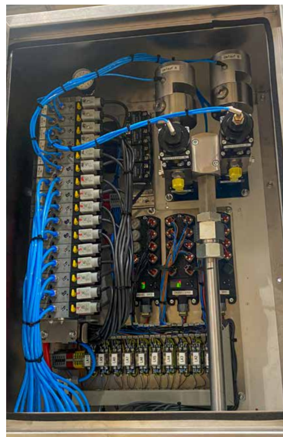
Aufgeräumt, übersichtlich und die neueste Technik eingebaut, so sehen die eigenen Steuerungen aus.
